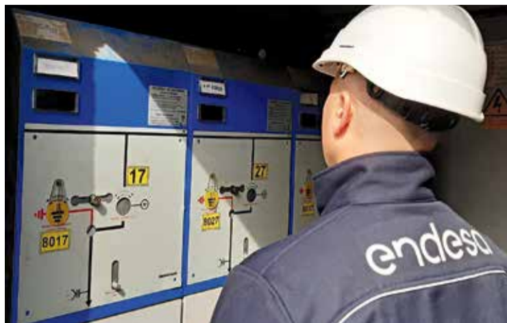
MÉS TECNOLOGIA. El nou cable permet millorar la xarxa elèctrica
