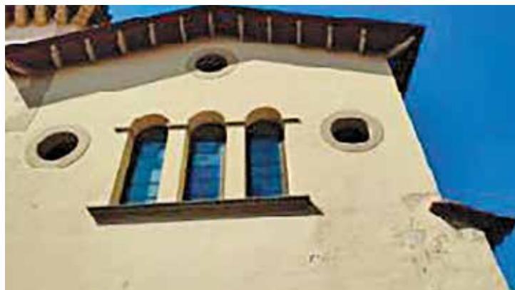
L'EDIFICI. Se sanejaran les parts bufades, esquerdades o erosionades
