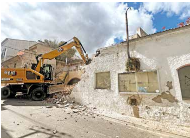
TANCAT FA ANYS. L'edifici tenia problemes estructurals i de salubritat B. GIRONÉS
